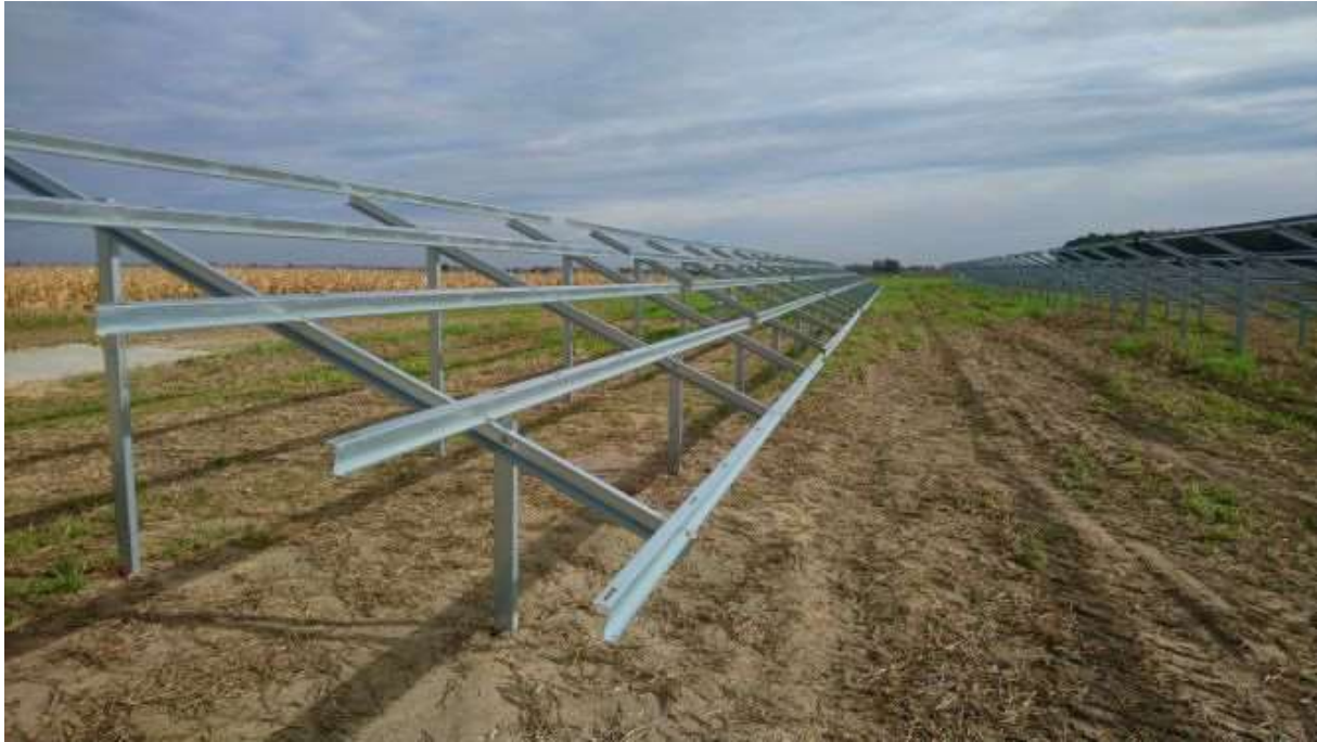
Zdjęcie 3 Konstrukcja przeznaczona do posadowienia paneli fotowoltaicznych.
