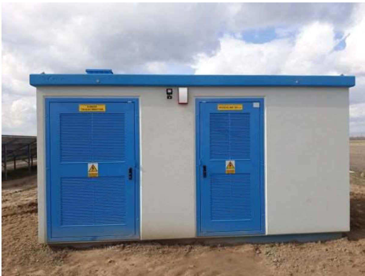
Rysunek 4 Widok na przykładową stację transformatorową.
