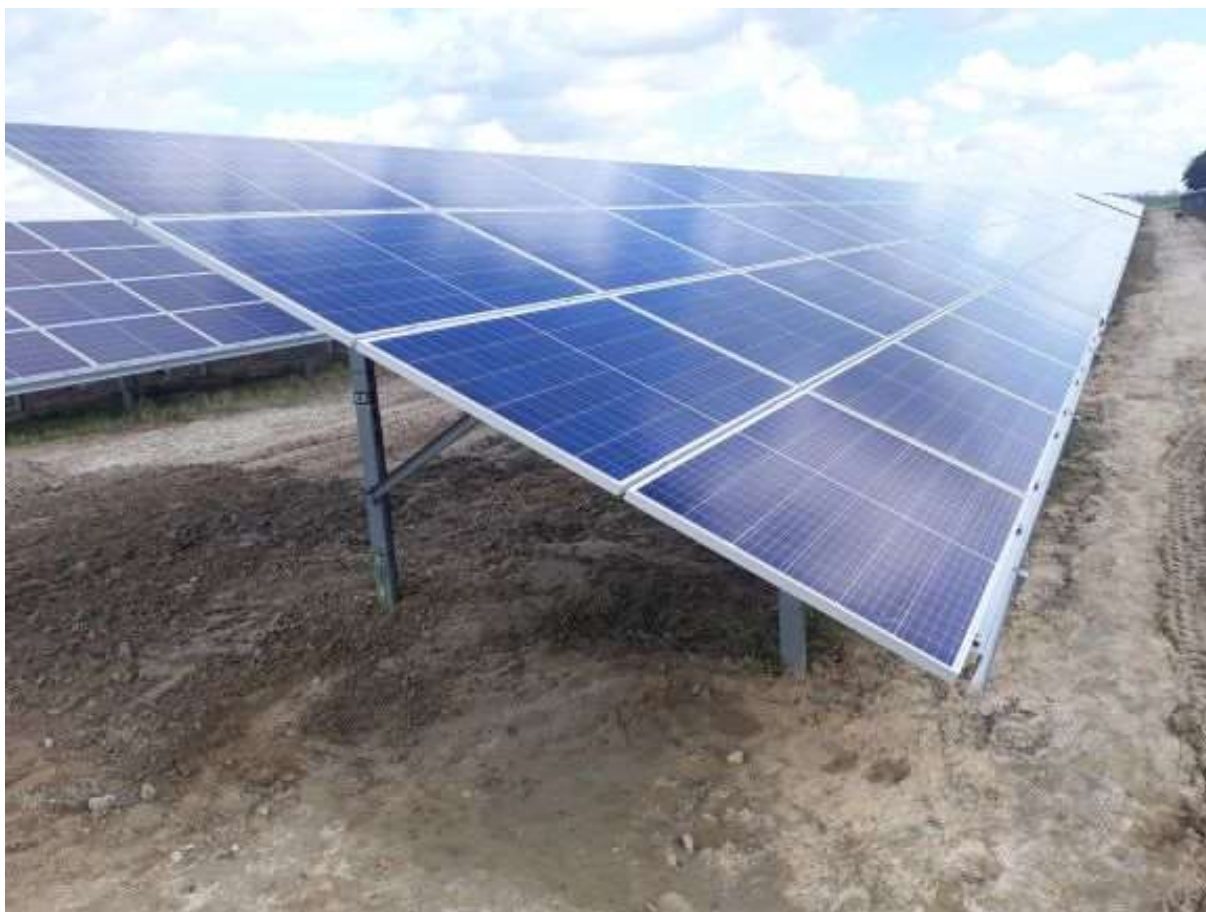
Zdjęcie 4 Przykładowe moduły fotowoltaiczne.
