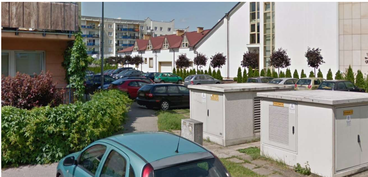
Zdjęcie 6 Standardowe stacje kontenerowe w otoczeniu zabudowy.
