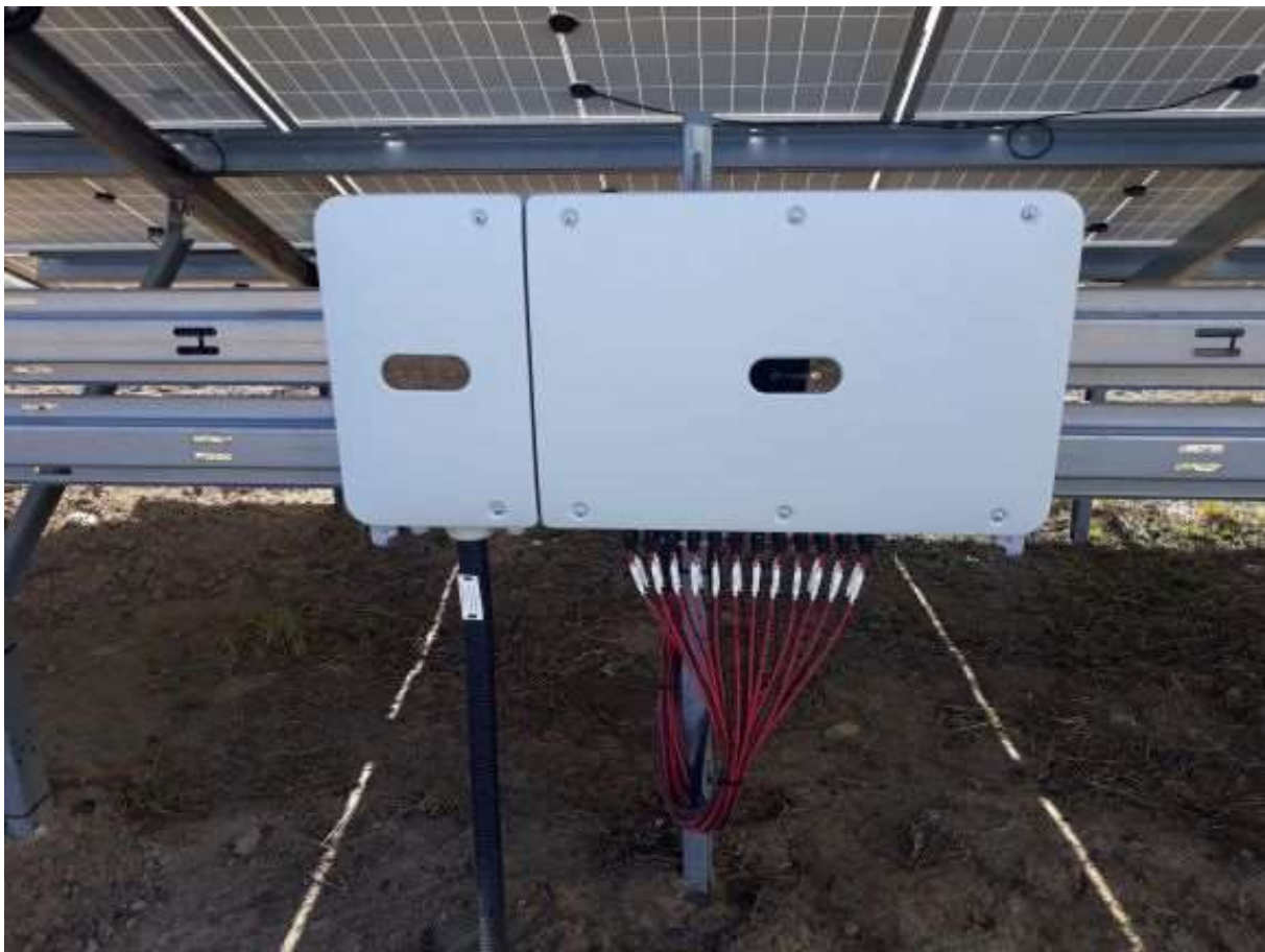
Zdjęcie 5 Przykładowy inwerter farmy fotowoltaicznej.
