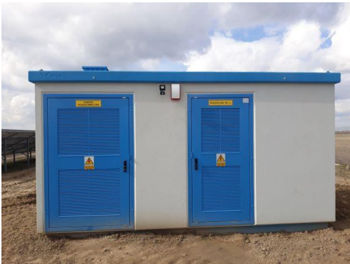
Rysunek 4 Widok na przykładową stację transformatorową.
