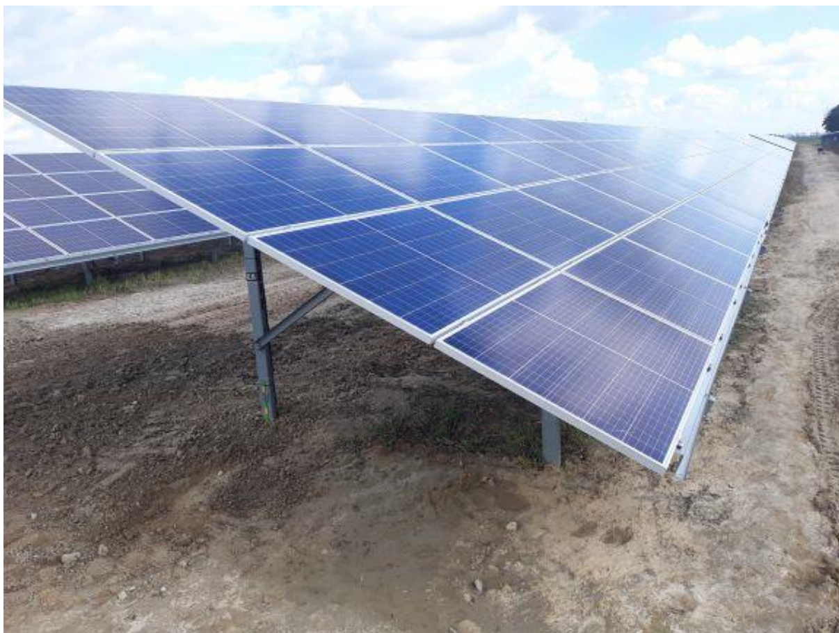
Zdjęcie 4 Przykładowe moduły fotowoltaiczne.
