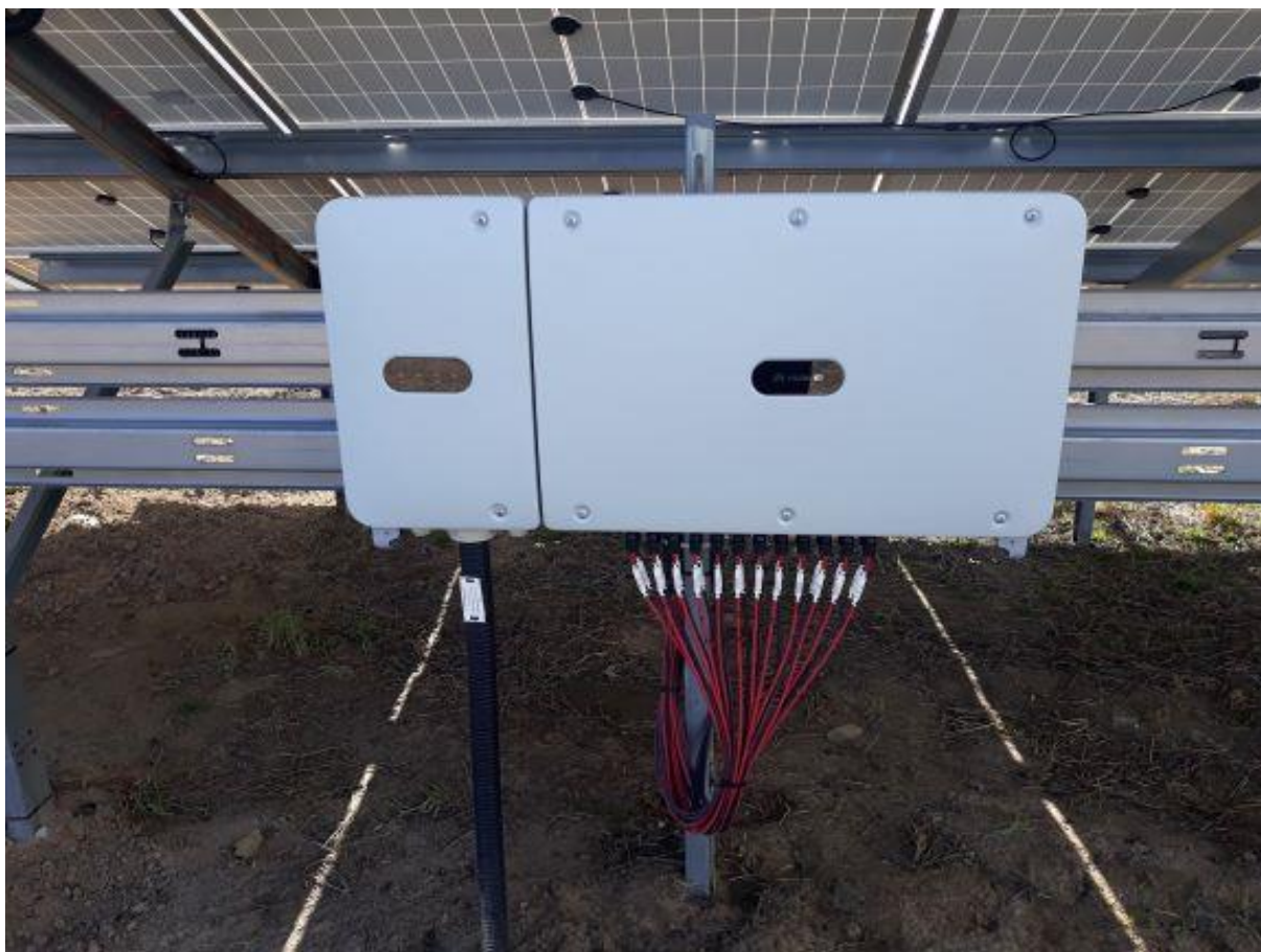
Zdjęcie 5 Przykładowy inwerter farmy fotowoltaicznej.
