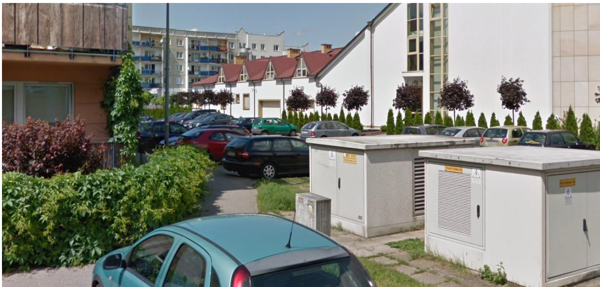
Zdjęcie 6 Standardowe stacje kontenerowe w otoczeniu zabudowy.
