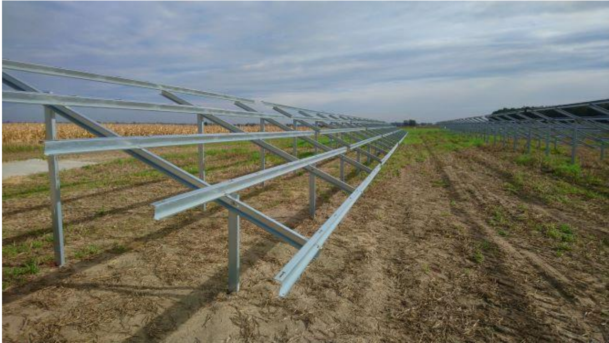
Zdjęcie 3 Konstrukcja przeznaczona do posadowienia paneli fotowoltaicznych.
