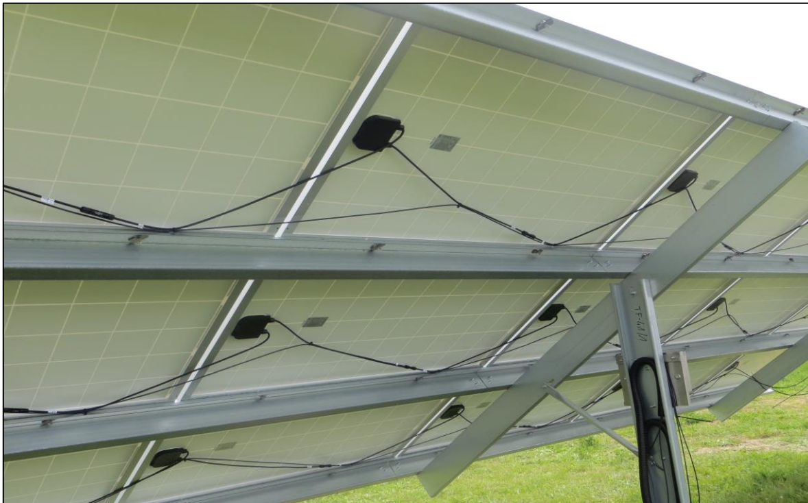
Fot. 6. Połączenia kablowe pomiędzy panelami fotowoltaicznymi
