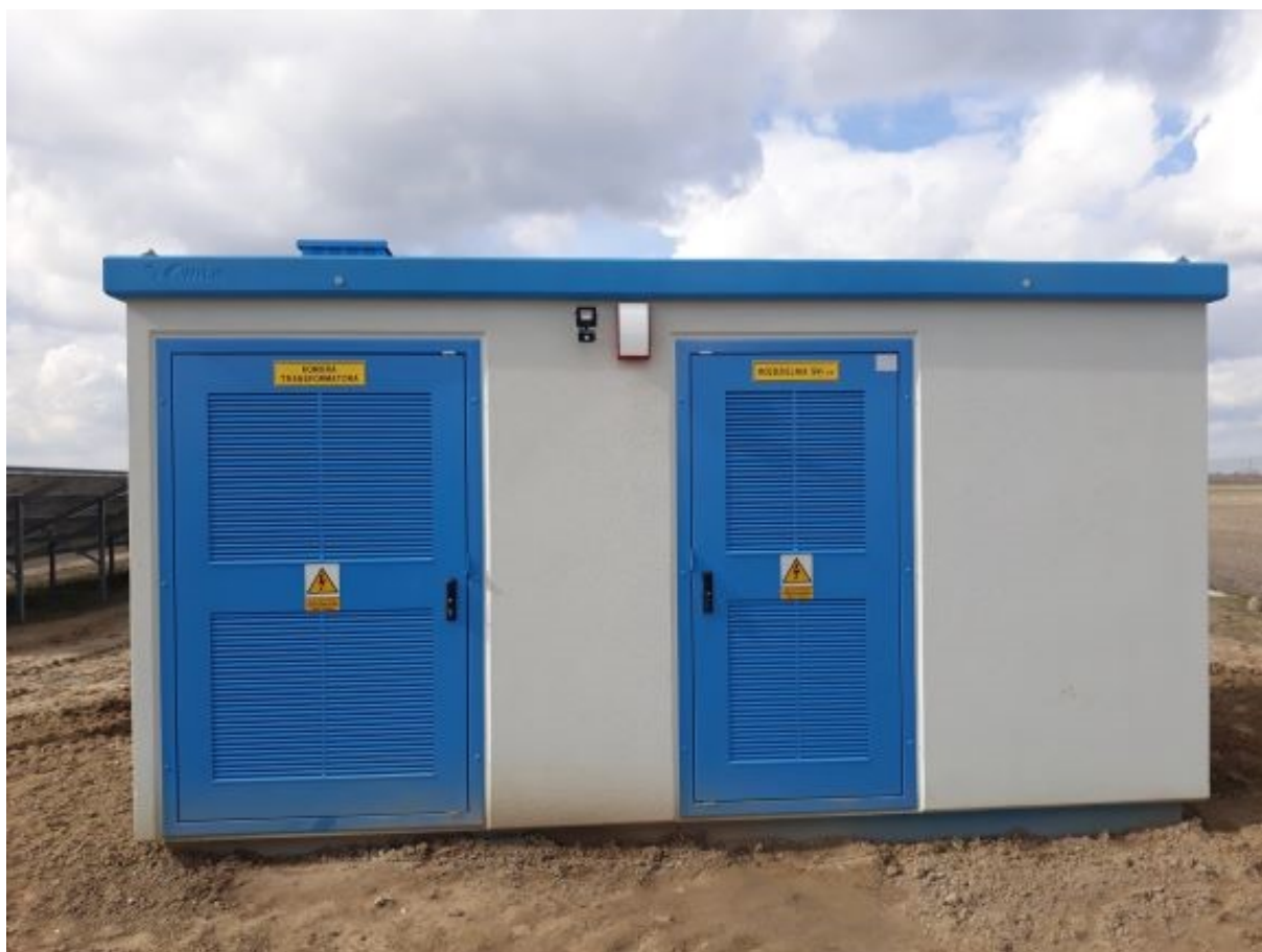
Rycina 10. Przykładowa stacja transformatorowa.
