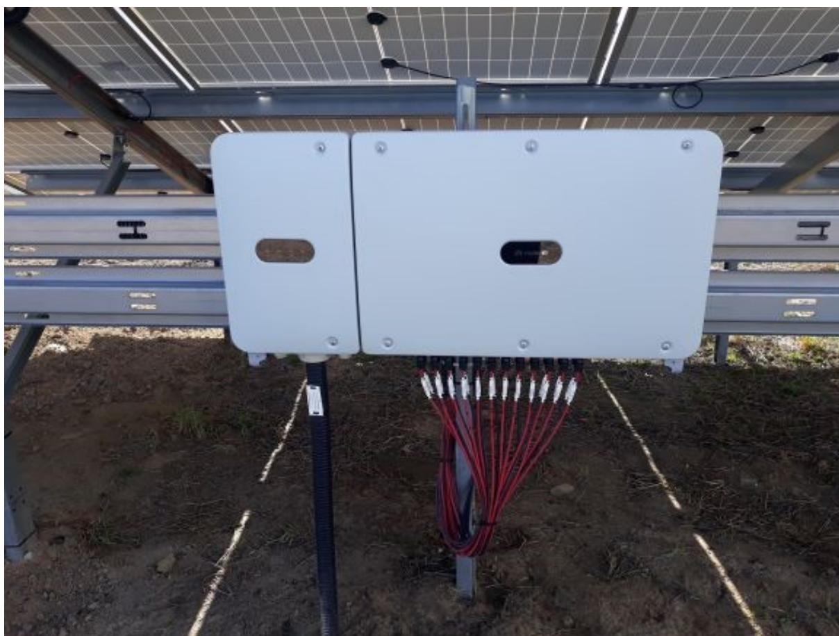
Rycina 9. Przykładowy inwerter farmy fotowoltaicznej.
