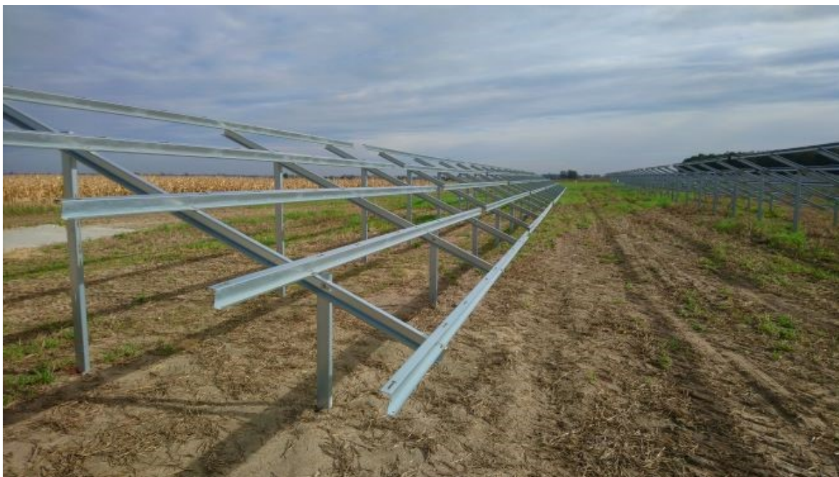
Rycina 5. Konstrukcja przeznaczona do posadowienia paneli fotowoltaicznych.
