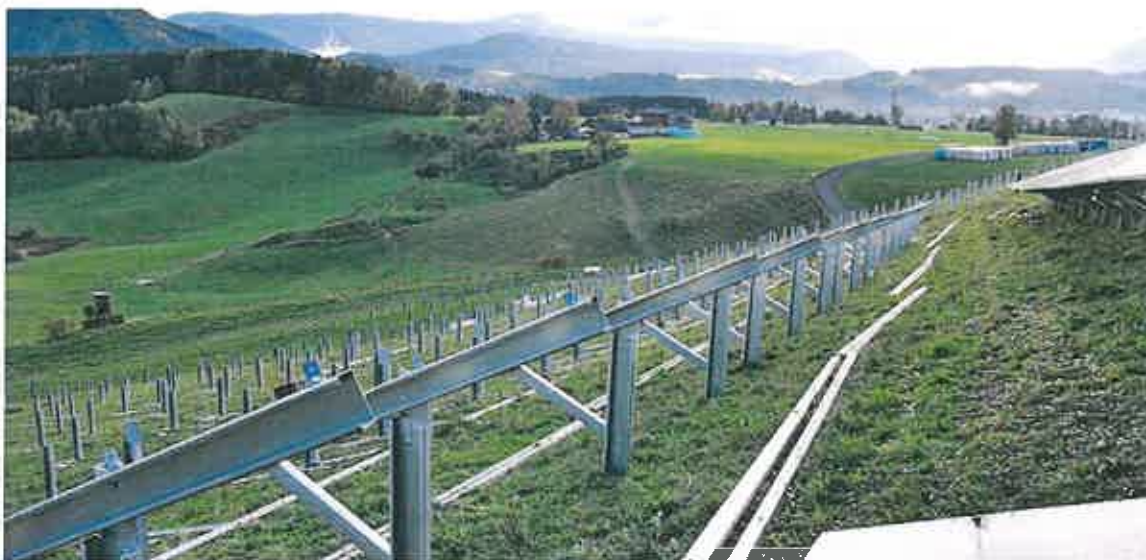
Zdjęcie 3 Konstrukcja przeznaczona do posadowienia paneli fotowoltaicznych.
