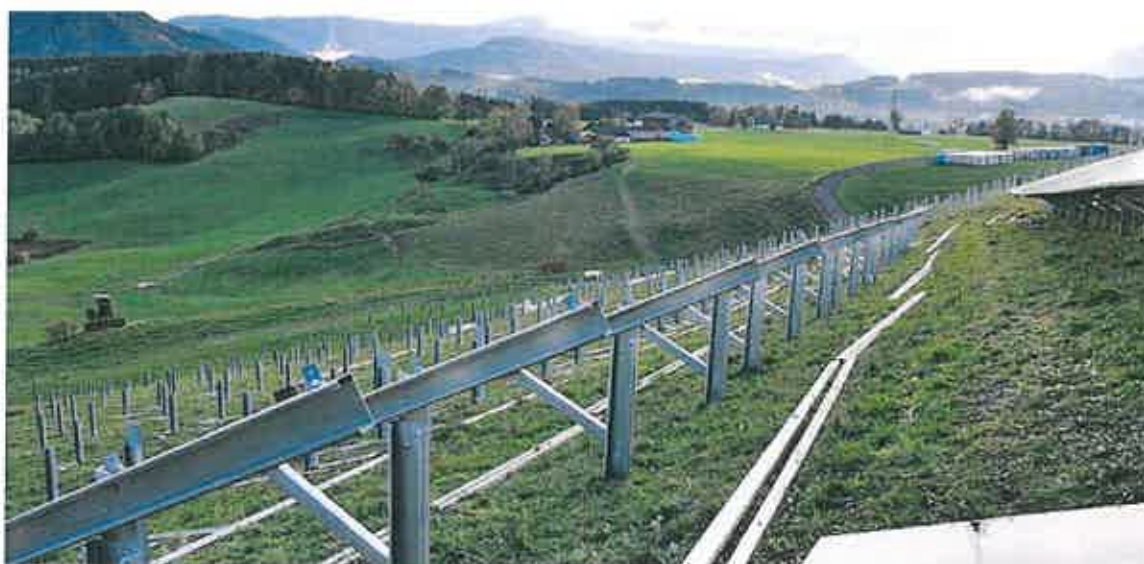
Zdjęcie 3 Konstrukcja przeznaczona do posadowienia paneli fotowoltaicznych.
