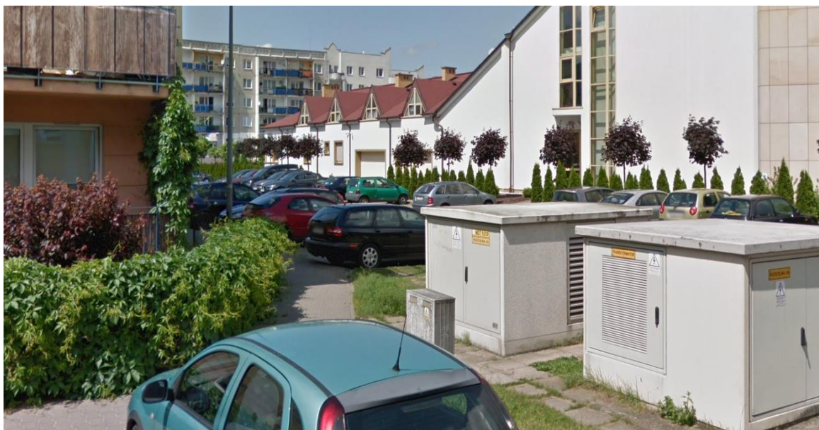
Rycina 10. Standardowa stacja kontenerowa w otoczeniu zabudowy.
