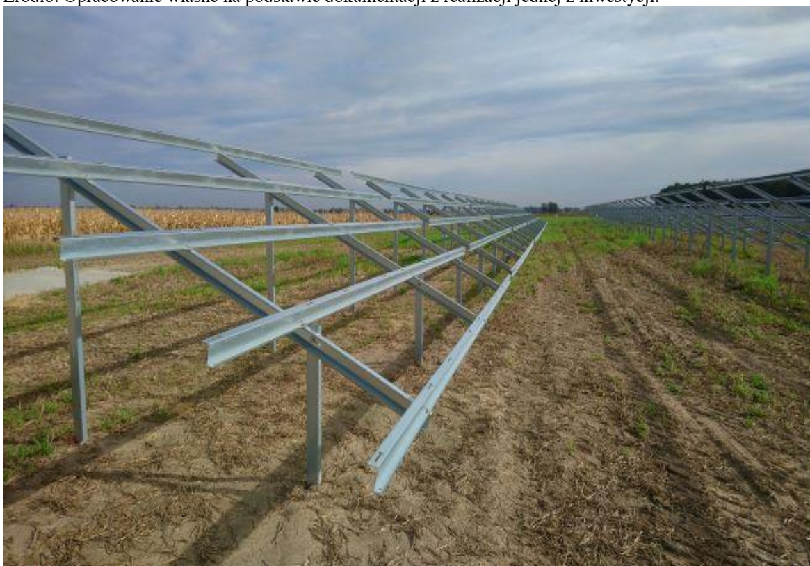
Rycina 5. Konstrukcja stała przeznaczona do posadowienia paneli fotowoltaicznych.
