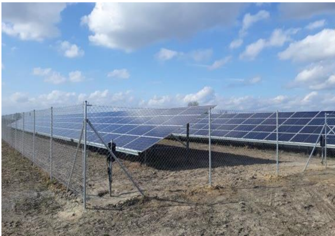
Rycina 12. Przykładowe ogrodzenie farmy fotowoltaicznej.
