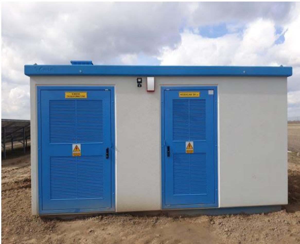
Rycina 9. Przykładowa stacja transformatorowa.
