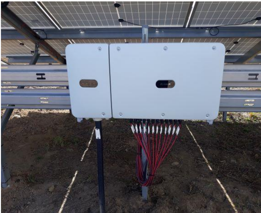
Rycina 8. Przykładowy inwerter farmy fotowoltaicznej.
