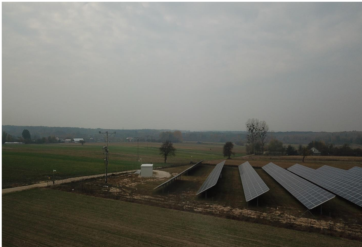
Zdjęcie nr 7. Widok stacji transformatorowej zainstalowanej na farmie fotowoltaicznej.
